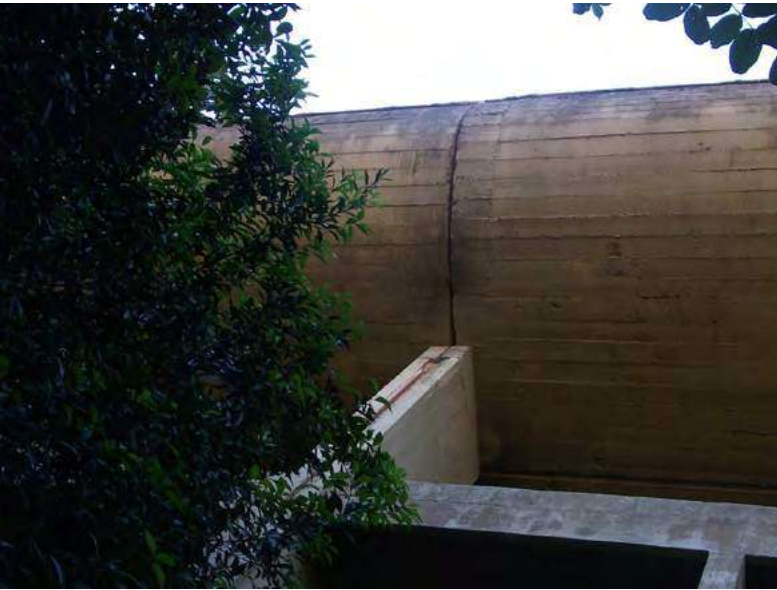
Imagen 11. Fotografía del autor que muestra la junta de dilatación producida modularmente cada tres aulas.
